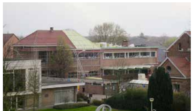
Heel wat stellingen rondom gemeentelijke basisschool Cade. Het dak wordt gerenoveerd en geïsoleerd.
